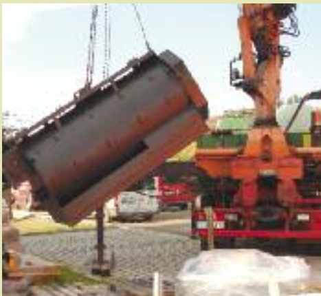
Der Holzpelletkessel der Heilhaus-Siedlung kommt, Foto: IWE Ingenieurberatung
